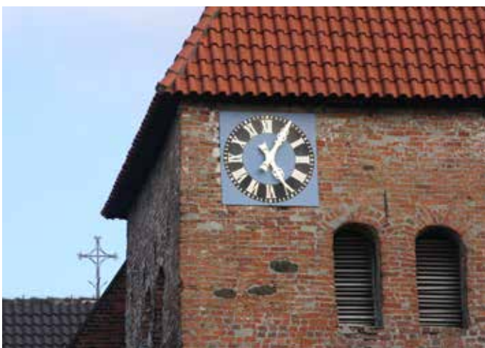
Deutlich erkennbar sind die mit Zement verstrichenen Stellen im oberen Teil des Turms. Foto: Torsten Kröncke
