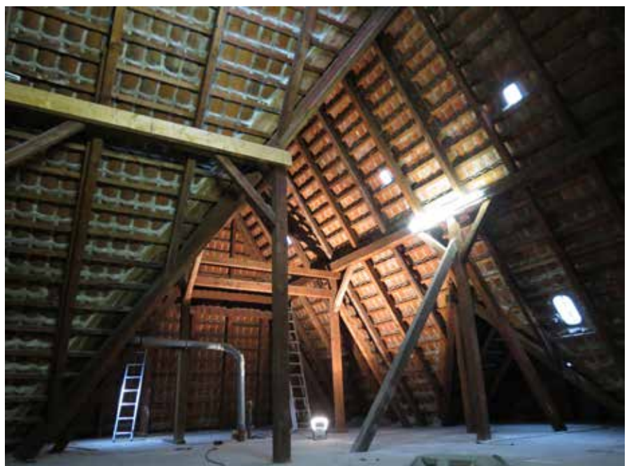
Viel Platz für neue Büros: das Dachgeschoss des Kirchenkreisamtes in Großburgwedel vor dem Ausbau. Foto: Bastian Hähling
