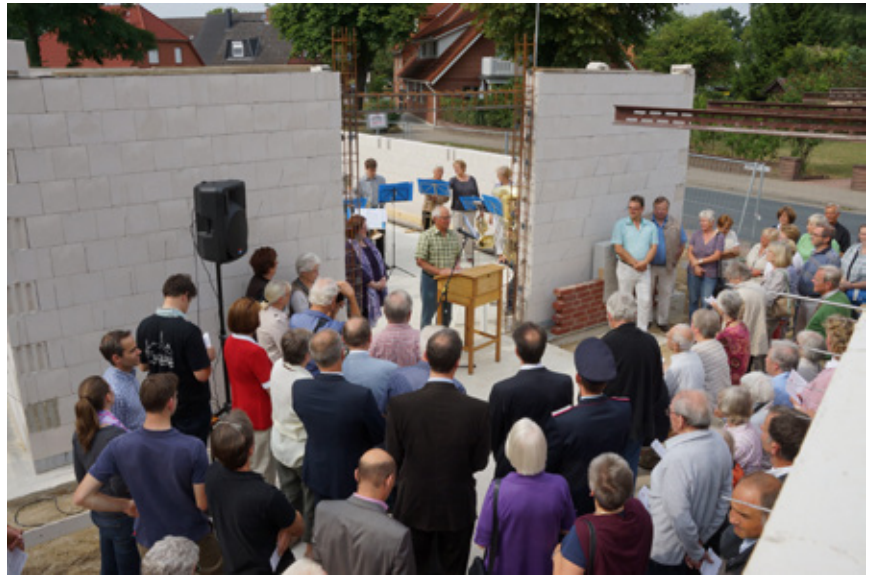
Die Mauern des ersten Stocks stehen bereits –der Neubau liegt gut im Zeitplan. Foto: khaki
